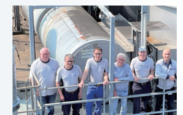
Regenerative thermal oxidizers (RTO)
