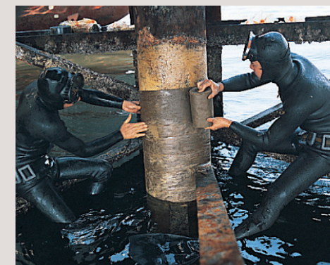
●海洋鋼構築物の防食
