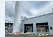
水素利活用設備
