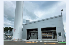
水素利活用設備
