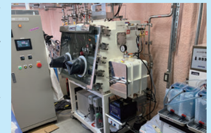
ギ酸製造設備
