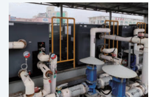
ヒートポンプ設備
